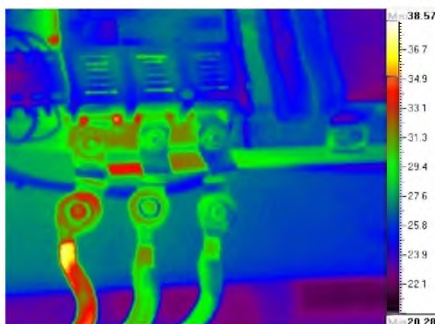
Рисунок 21. Пример термограммы контактных соединений с температурной шкалой
