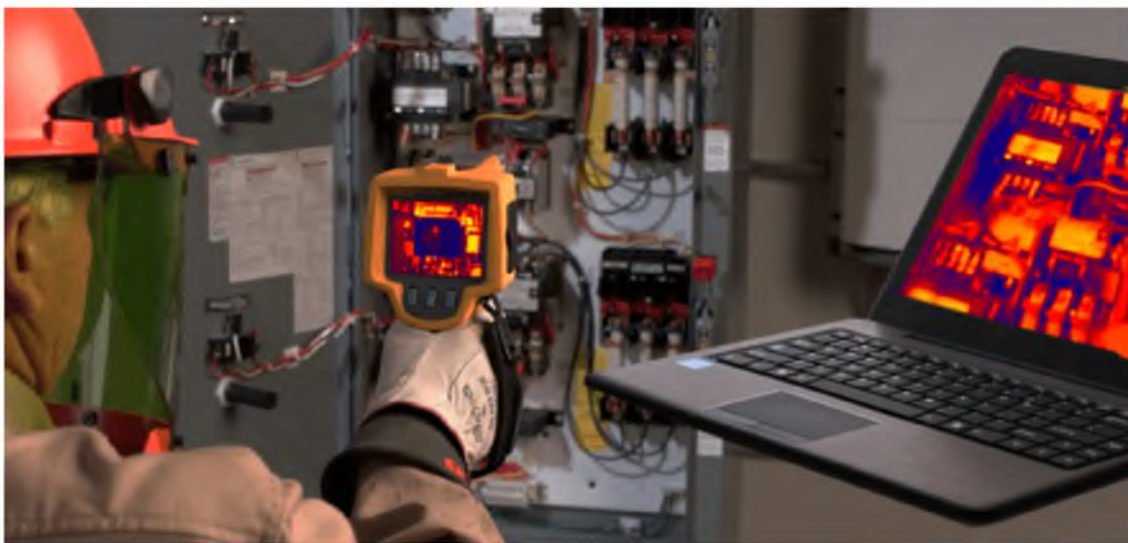
Рисунок 20. Пример проведения тепловизионного контроля электрошкафа
